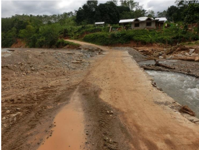
天端コンクリート(水の流れ；左から右) 右側(下流側)の縁石がほぼすべて流されてしまっています。
