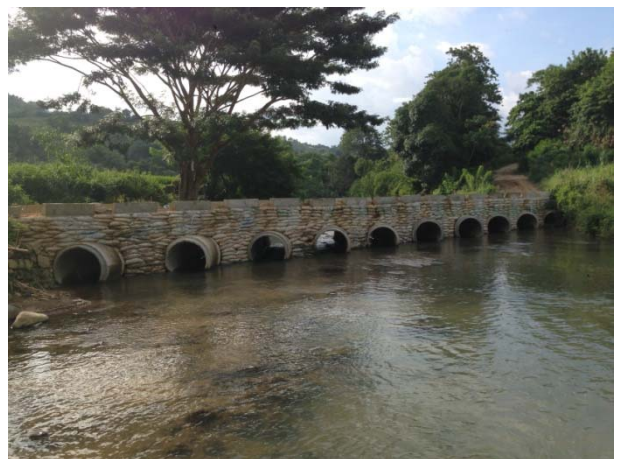
現地調査時_2015 年 9 月_from Camera C
