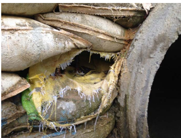
写真 5 河川の増水により損傷した壁面部分。今後、村人により補修工事が実施される
