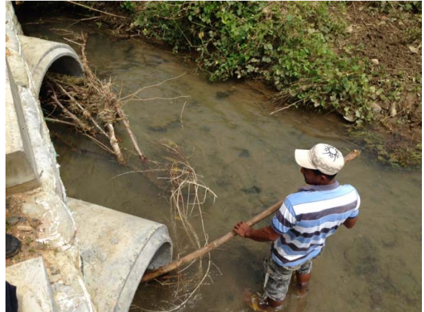
カルバート管流入部にて浮流物が詰まっている _2015 年_from Camera F
