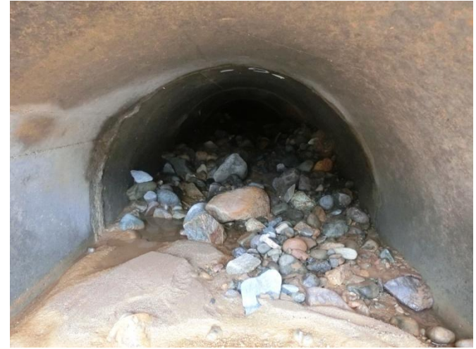
土砂の詰まったカルバート管 いくつかのカルバートは写真のように土砂がつまり水が流れなくなっています。
