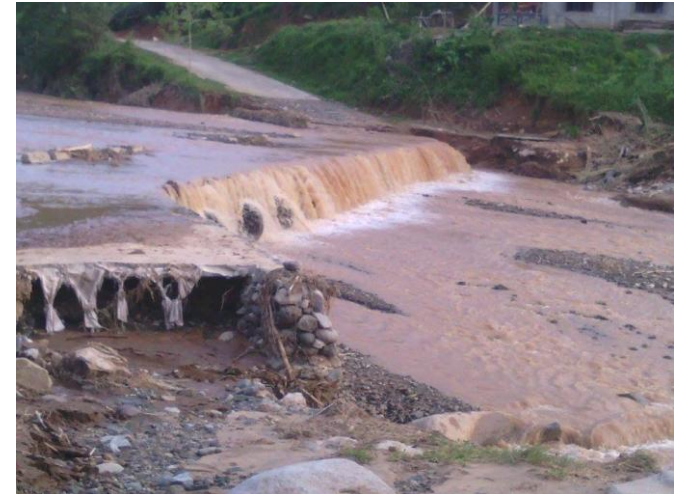
越流時の河川の様子 橋の端部(写真手前)部分が洗掘によりえぐれてしまっています。
