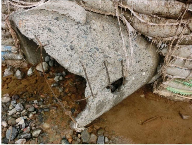
損傷を受けたカルバート管(下流側、小川の流れを受ける箇所) 一番ひどいカルバートです。鉄筋が見えるくらい破壊しています。
