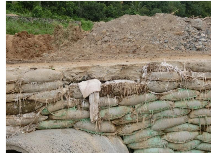
下流部の壁面 こちらも損傷なしですが、縁石近くの土のうは一緒に剥がれてしまっています。
