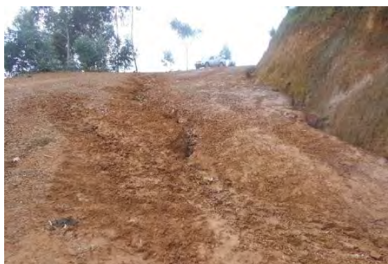
施工前の洗堀がひどかった状態
