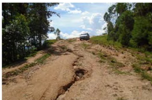
施工前 雨季には洗堀され通行不可能な状態
