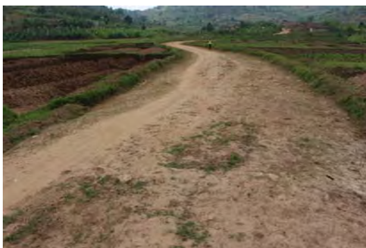
施工前の降雨時には水が溜まっていた状態
