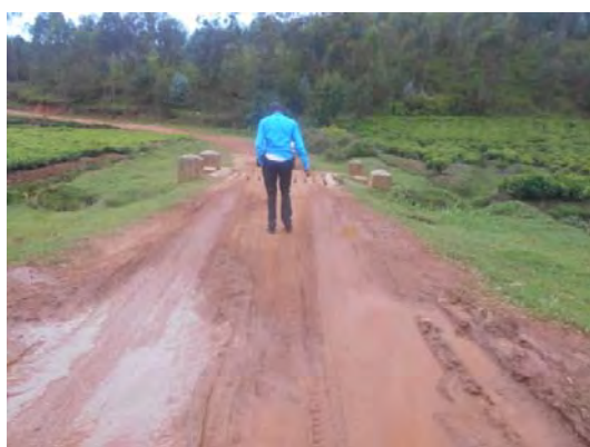
施工前の水はけが悪くぬかるんだ状態
