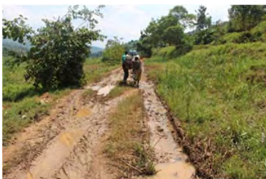
施工前のぬかるみと橋の傷みで車両通行が不可能な状態
