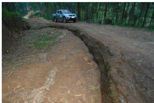
洗堀が深刻で車両通行が困難な箇所
