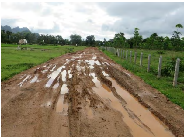
⑤ 改築時に土の締固めが十分でなかった箇所。改築後の雨季に大型トラックが多数通行しダメージを受けた。そのため、再度、維持管理研修も含めた改築工事を行った。
