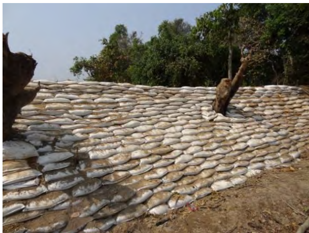
⑤ 土のうによって嵩上げされた道路の側面
