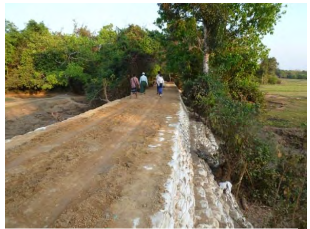
⑥ 土のうによって嵩上げされた道路
